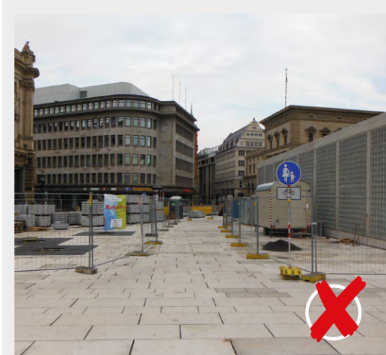
Bild 3 | schlecht sichtbare Absperrung
