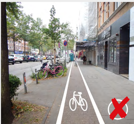
Bild 12 | Gerüst auf Radweg mit schlecht sichtbarer Sicherung
