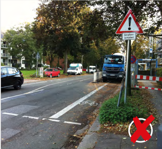
Bild 14 | Arbeitsstelle auf Radfahrstreifen ohne Absicherung
