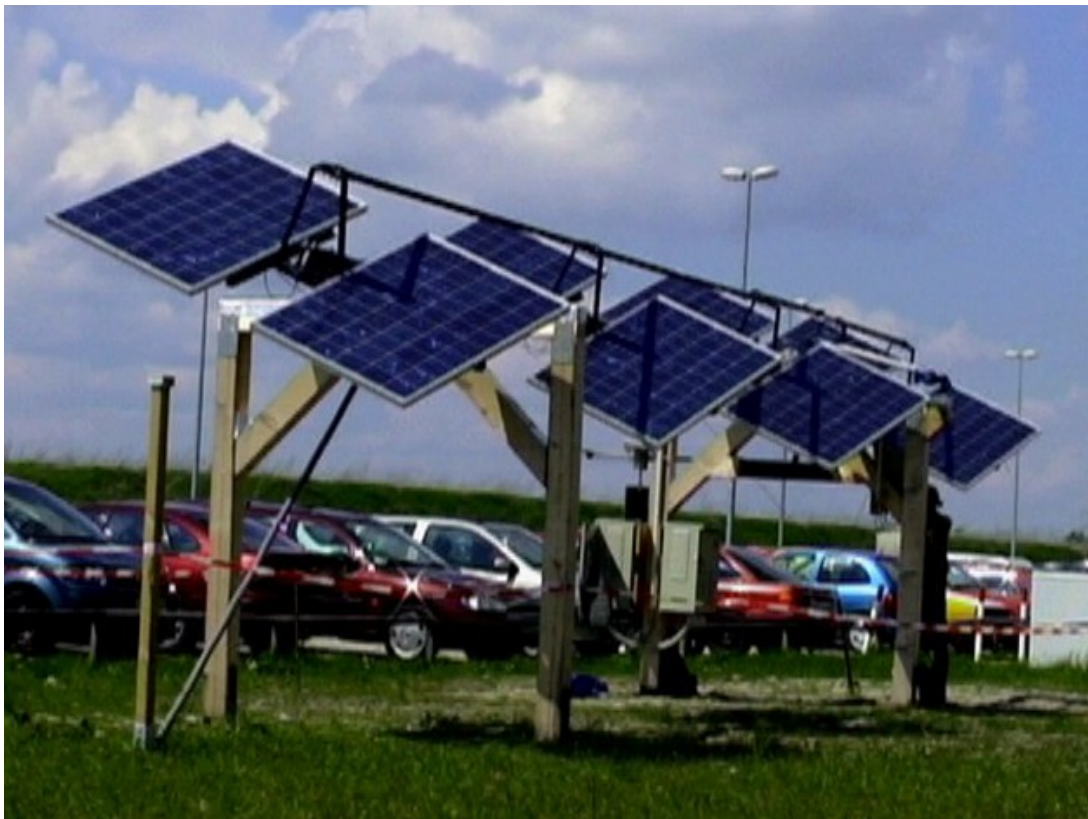
Die Anlage mit den um zwei Achsen drehbaren Solarmodulen VIAX
