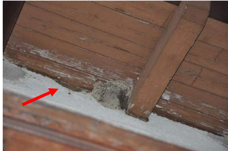
Mauerseglerquartier links neben Rauchschalbennest
